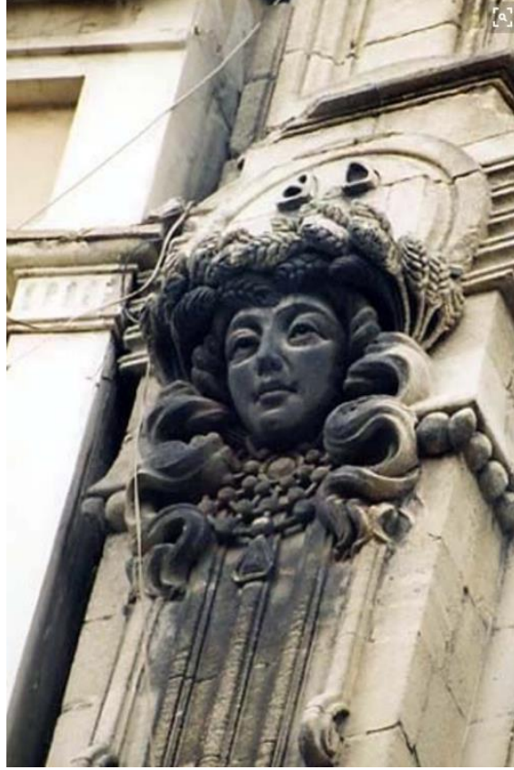
R. 141 Botter Apartmanı Dış Cephesi, Kadın Başları Maskları 3. Ve 4. Kat Hizası, İstiklal Caddesi, Beyoğlu
