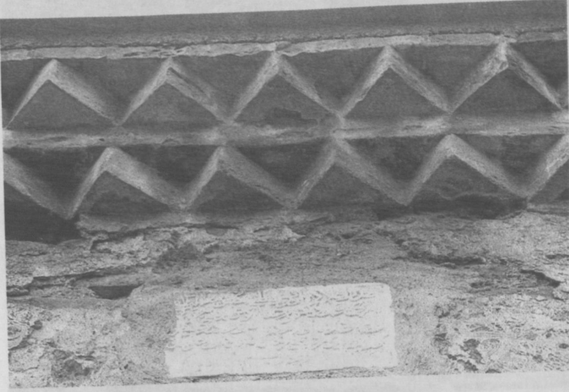
Lev. 54: Dış avlu, güney taçkapı arka yüz, onarım kitabesi.
