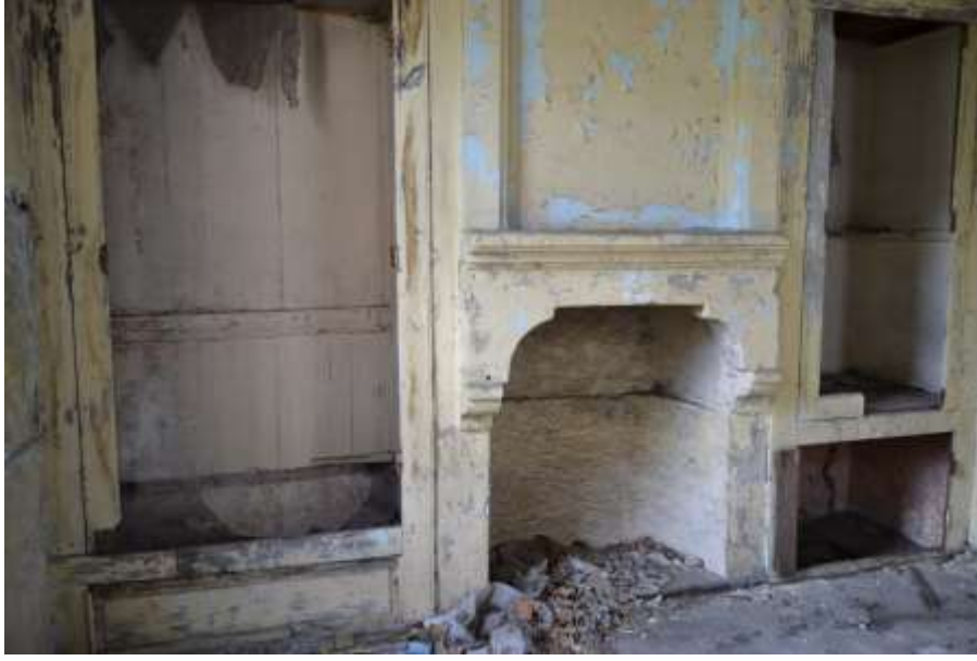
Şekil 2.101: Z07 odada bulunan DP1 poz numaralı dolap
