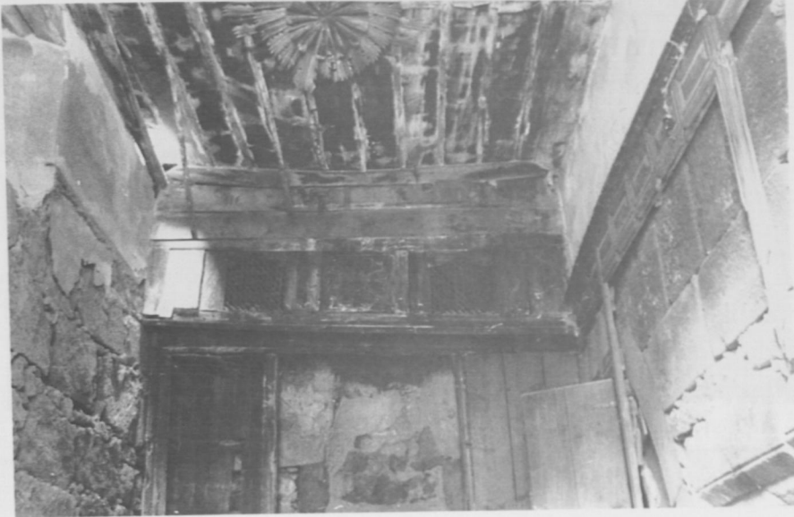
Fot. 51- Kayseri, Hoca Hasan İmaretinin giriş holünün üstünü örten tonoz yıkılmış olduğundan yerine muhdes ahşap tavan yapılmıştır (1976).
