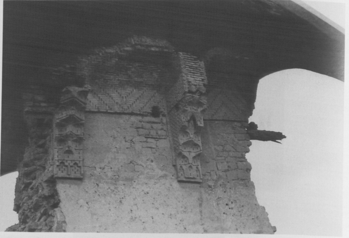
Fot. 18- Konya, Kılıç Arslan Köşkü. Tuğladan inşa edilmiş mukarnaslı konsollar ve tonoz kalıntısı (1963).
