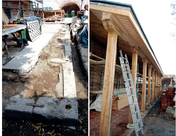
Fotoğraf 6. Caminin doğu cephesinin ön kısmında eskiden bulunan saçakların ahşap taşıyıcılarının oturduğu kaideler ve özgün döşeme (M.Sav, 7.7.2014).
