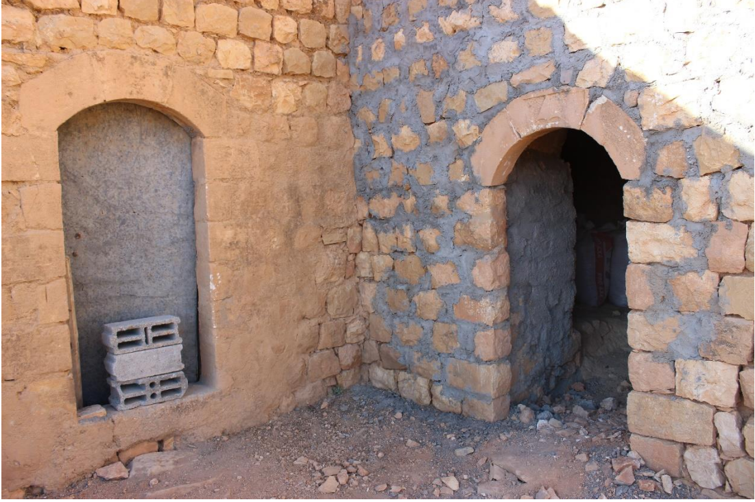
Şekil 5.16: Çimento malzemesi ile müdahale yapılmış yapı (Ö.Yıldız, 2018)
