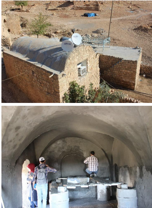
Şekil 5.17: Yapılara koruma amacı ile uygulanan niteliksiz malzeme
