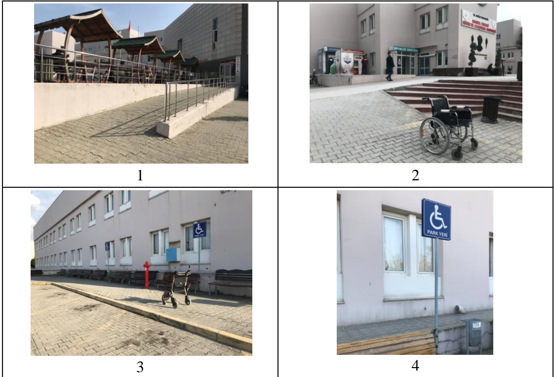
Resim 5.2: Hastane dış mekanı, engelli otopark alanı ve Genel Poliklinik alanına ulaşım yol güzergahı (Erol, M. Arşivi, 2020)
