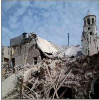
Şekil 4. 20 Ortodoks Ermeni Katedrali, Güney Dış Cephesinde Hasarı 2015, Haddad, A.
