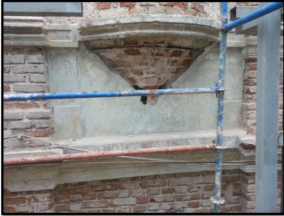
Şekil 3.76: Güney cephede mihrap nişinde bulunan betonarme eklenti.
