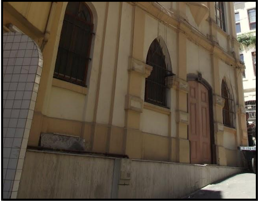
Şekil 3.71: Güney cephesinde bulunan yuvarlak kemerli ve sivri kemerli pencerelere sonradan eklenmiş demir parmaklıklar.
