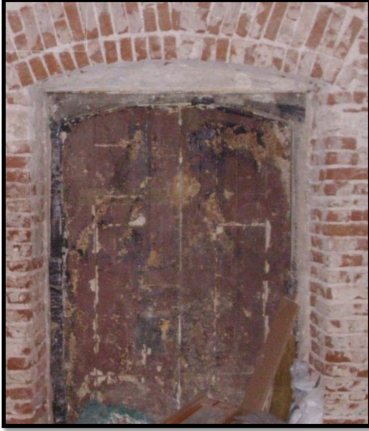
Şekil 3.92: Güney cephede bulunan kullanılmayan kapıda oluşan değişim ve bozulmalar.
