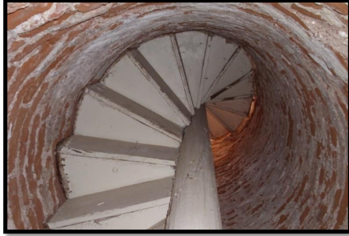
Şekil 3.95: Minare merdivenlerinde oluşan çürümeler.
