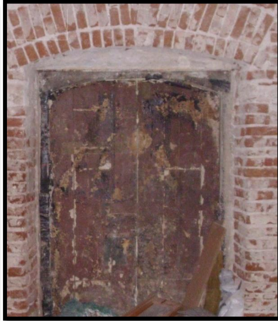
Şekil 3.39: Güney cephesi kullanılmayan özgün ahşap kapı DV2 K2 numaralı kapı iç görünüş.
