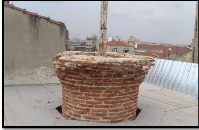
Şekil 3.94: Minare seren direğinde oluşan çürümeler.
