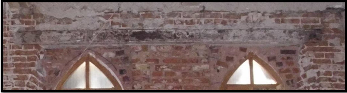
Şekil 3.93: Güney cephede bulunan sivri kemerli pencerelerin üzerinde bulunan ahşap hatıl oluşan değişim ve bozulmalar.
