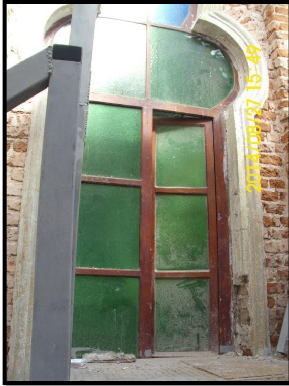
Şekil 3.83: Doğu cephesinde yonca kemerli pencerenin sövelerinde dökülmeler.
