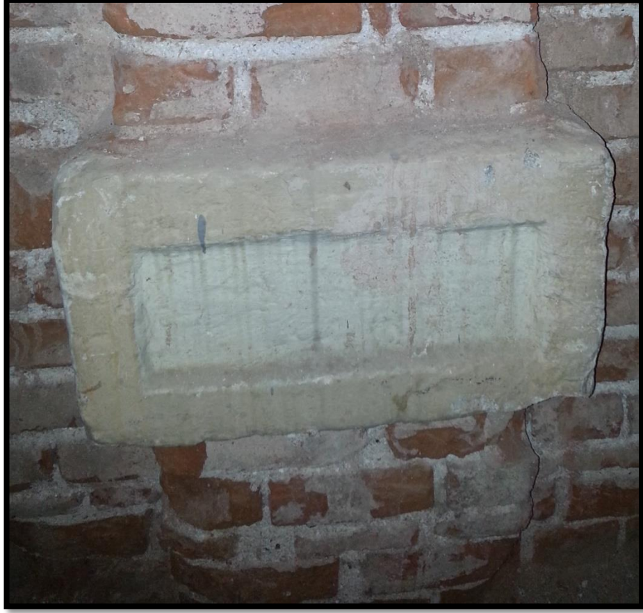
Şekil 3.90: Dikdörtgen çerçeve de oluşan renk değişimleri.
