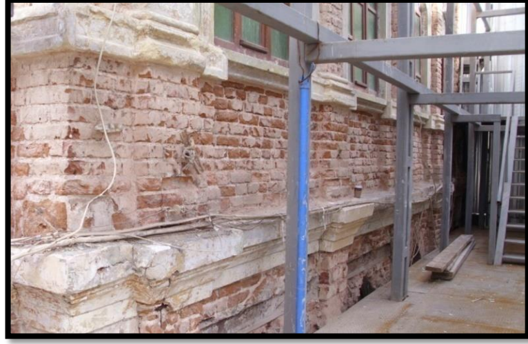
Şekil 3.63: Doğu cephesinde bulunan Kat silmesi ve altındaki tuğla duvarda bulunan yapısal çatlak.
