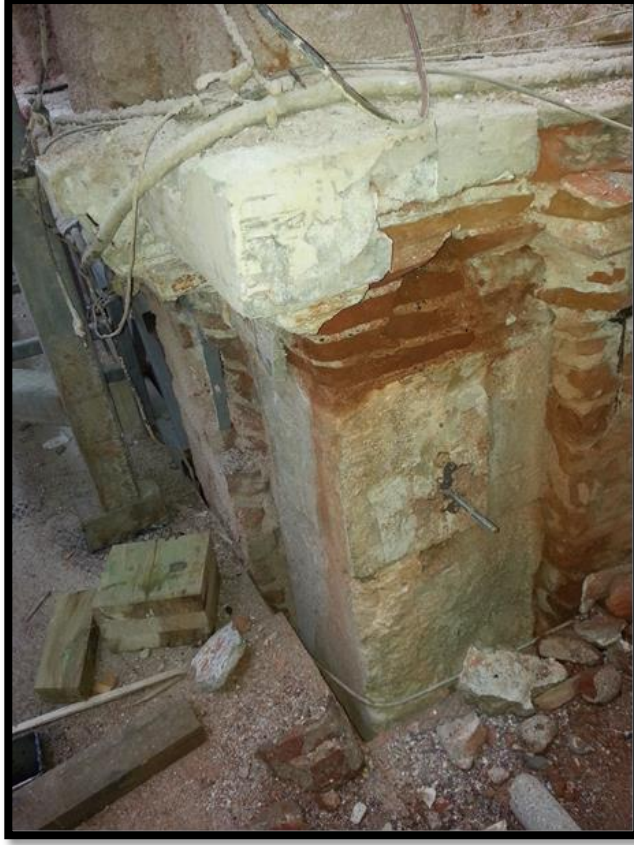
Şekil 3.84: Camii'nin güneydoğu cephesinde malzeme zamanla doğal nedenlerden dolayı oluşan dökülme.
