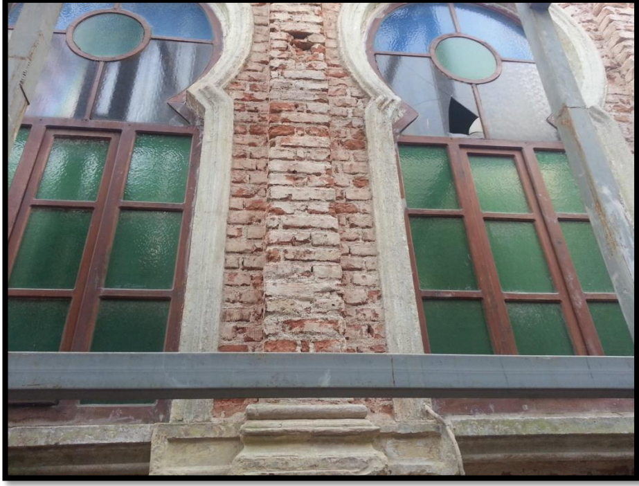
Şekil 3.82: Doğu cephesinde bulunan sütunçe üzerinde doğal nedenlerde dolayı kütle kaybı.
