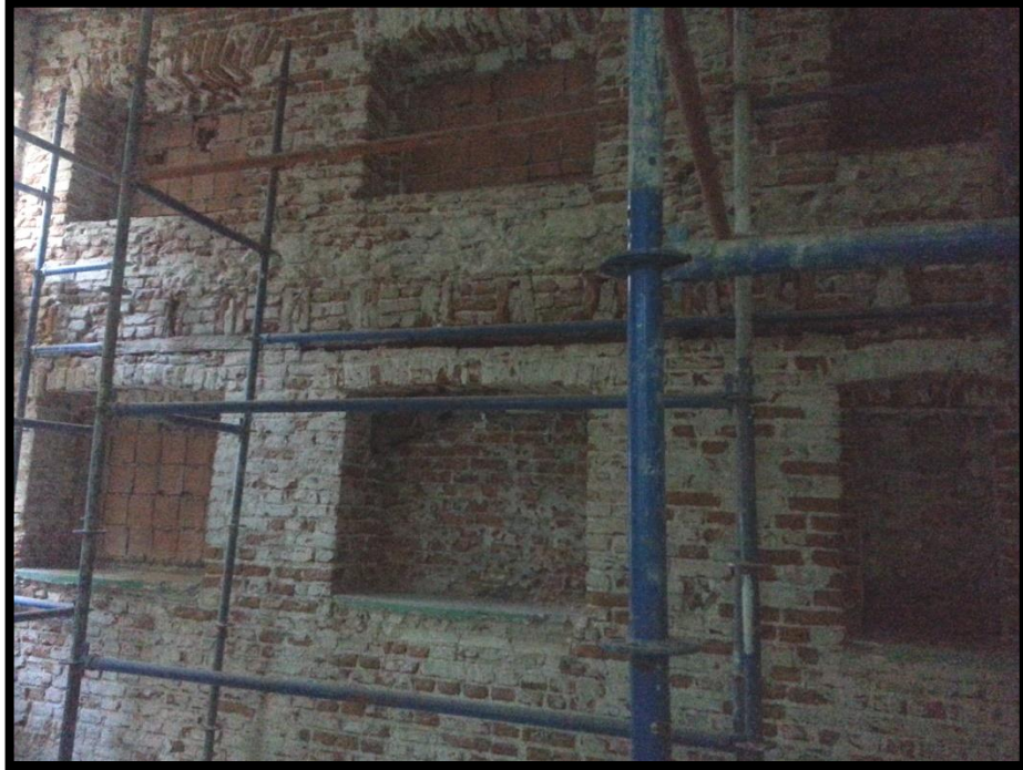
Şekil 3.81: Birinci kat mescit alanı batı duvarında bulunan işlevini yitirerek kapatılan pencere boşlukları
