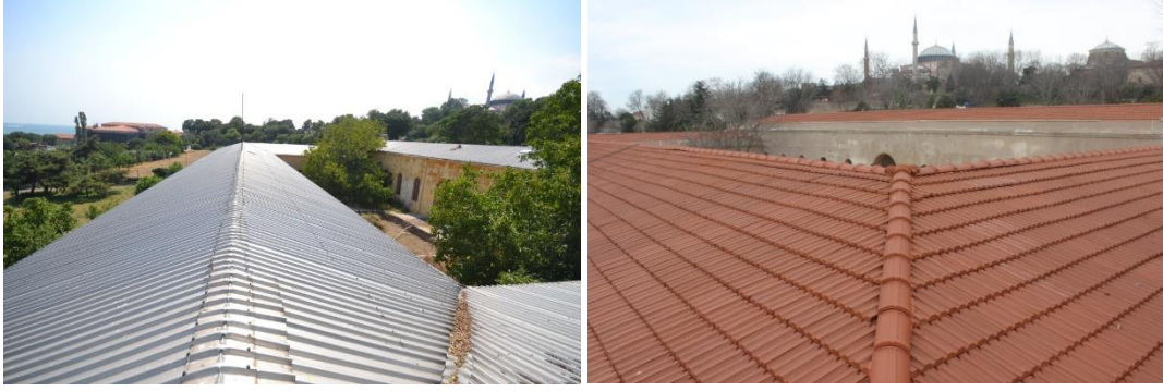
Görsel 161 Eski Askeri depolar uygulama öncesi (solda), uygulama sonrası (sağda), (Öcal, 2016)
