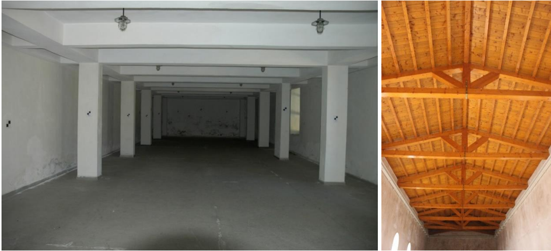
Görsel 162 Eski Askeri depolar uygulama öncesi (solda), uygulama sonrası (sağda), (Öcal, 2016)
