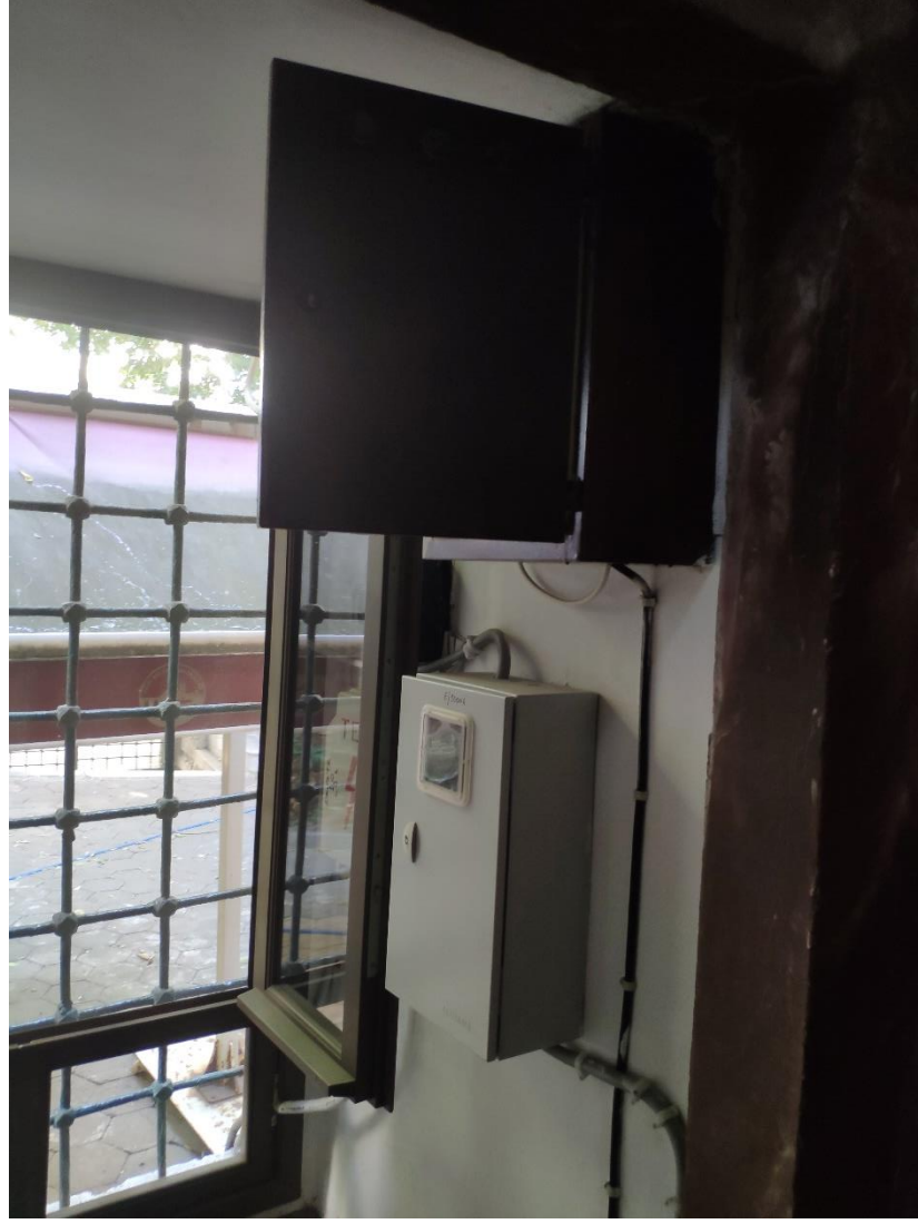
Şekil 3.27 Z04 Müezzin Mahfili Elektrik Panosu (S. Çakır, 2020)
