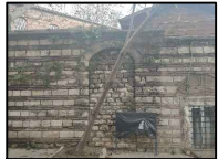
A. KAPTANI DERYA İBRAHİM PAŞA SOKAĞINDA BULUNAN DOLDURULMUŞ BAHÇE DUVARI AÇILMIŞTIR.
