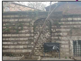
A. KAPTANI DERYA İBRAHİM PAŞA SOKAĞINDA BULUNAN DOLDURULMUŞ BAHÇE DUVARI AÇILMIŞTIR.
