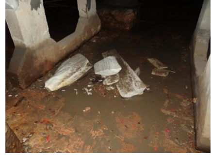
Şekil 4. 79. Sütunlarda gözlemlenen malzeme kayıplarından örnekler (Hera Rest. Arşivi).
