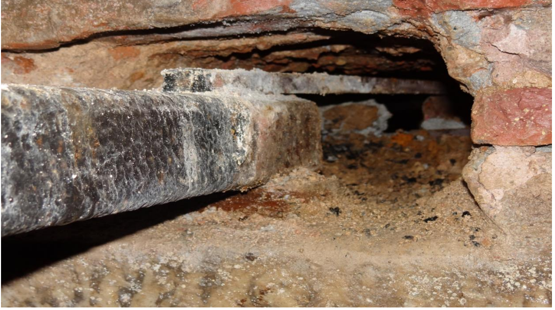
Şekil 4. 120. Korozyona uğramış gergi demiri detayı (Hera Rest. Arşivi)
