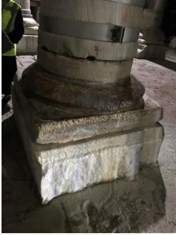
řekil 4. 77. Malzeme kaybı olan kaide detayı
