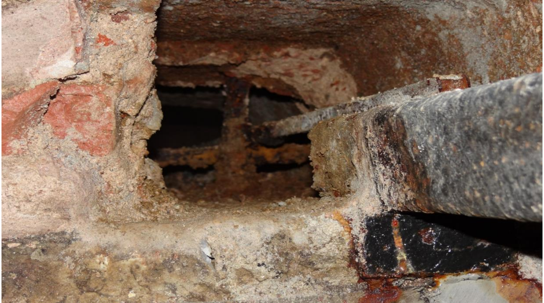
Şekil 4. 121. Korozyona uğramış gergi demiri, kenet ve gergi boşluğu detayı (Hera Rest. Arşivi).
