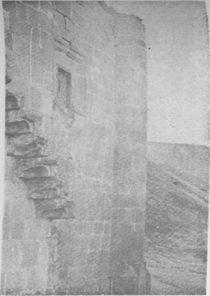
Resim : 15 — Darülhadisın Kuzey doğu köşesindeki istinat kulesi. (Tayyip Başer'in arşivinden)
