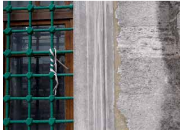
Fotoğraf 14. Cephelerde çimento bağlayıcılı harç ile yapılmış uygun olmayan onarımlar.
