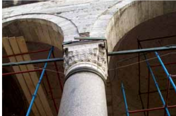
Fotoğraf 17. Korozyon nedeniyle hasar görmüş sütun başlığı ve üzen-gi taşı ile korozyona uğramış ve kopmuş demir kuşak.
