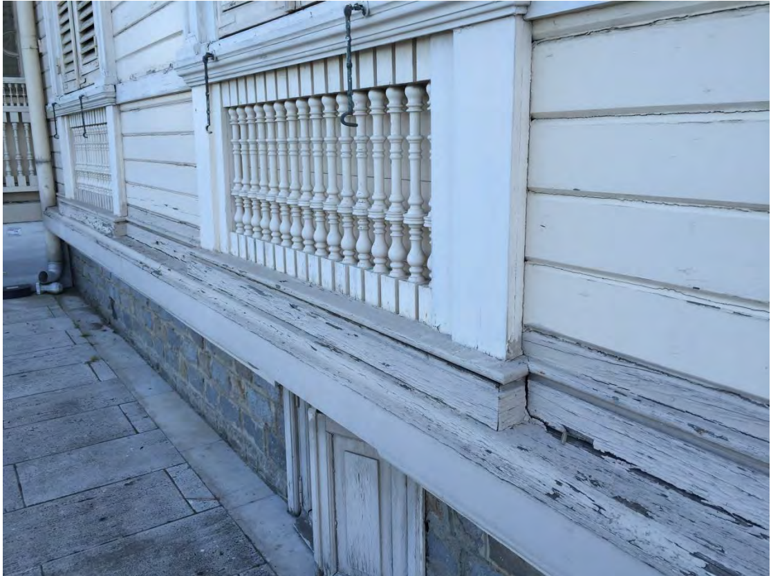
Resim 4.42 Huber köşkü cephe aşınmaları
