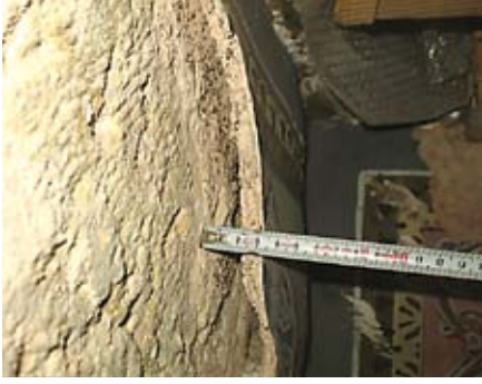
Sıva duvar arasındaki boşluklar
