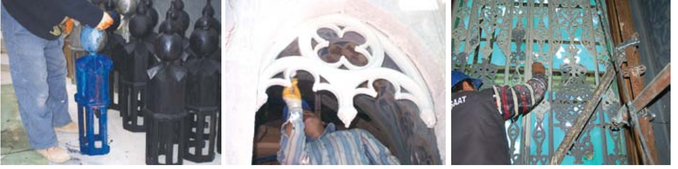
Dökme Demir Yaşmak, Şebeke ve Tepeliklerin Bakımı
