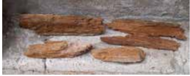
Fotoğraf 15-16. Dışlık pencereleri altında çıkan ahşap hatıllar ve çürümüş parçalar
