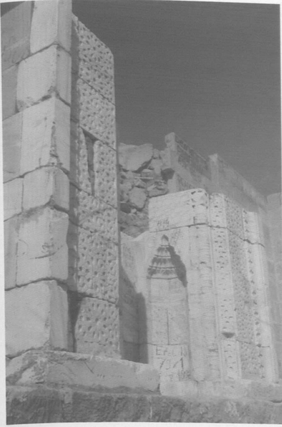
Res.27: Hıdırellez Köşkü portalı (onarım yarım bırakılmış).
