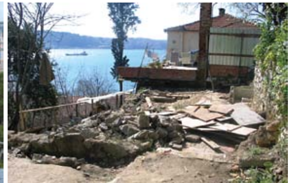
Resim, 25- Kazı rölövesi onaylı 7 nolu yapının temelleri ve 5 nolu meşrutaya bitişik, altı We olarak kullanılan teras, 6 nolu meşrutanın yeri
