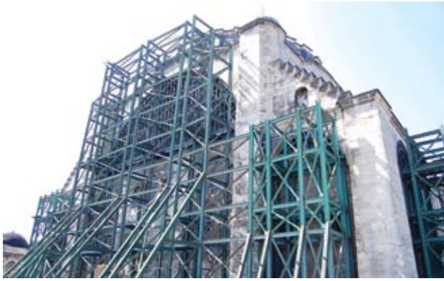
Resim 11-Mihrap cephesindeki çelik konstrüksiyon desteği
