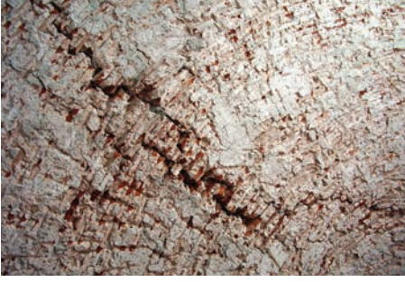
50.Yapı strüktüründeki tonozlardaki yapısal çatlaklar / rölöve
