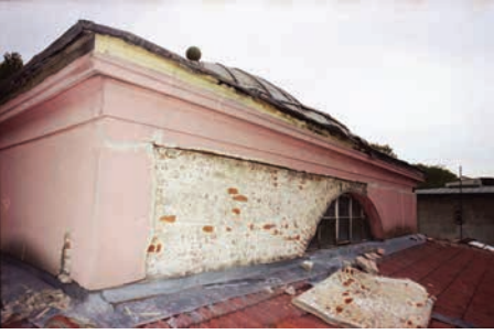
19. Dış sıvada aderans sorunu, siva ayrışması, rölöve
