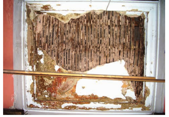
48. Onarım öncesi çürüyen bağdadi çıtalar / rölöve
