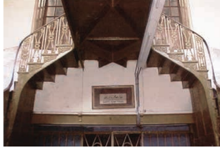
22. Onarım Öncesi giriş merdiveni
