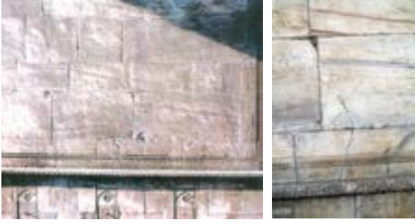
Fotoğraf 16-17. Güneydoğu cephesinde çatlak, parça kopmaları Restorasyon öncesi (2001) ve sonrası (2013)
