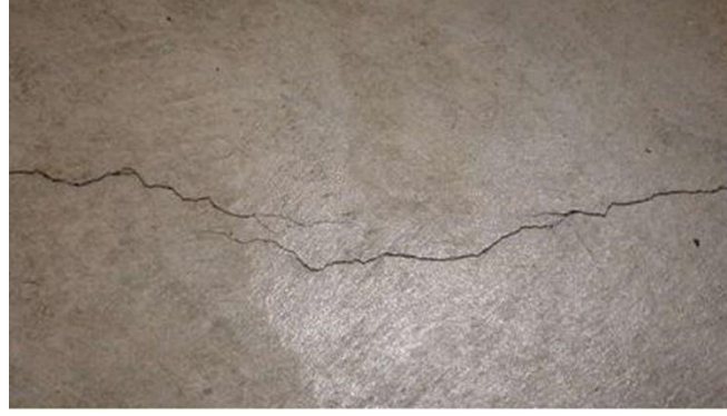
Resim 4. Uçucu kül katkılı betonda rötre çatlakları [11]
