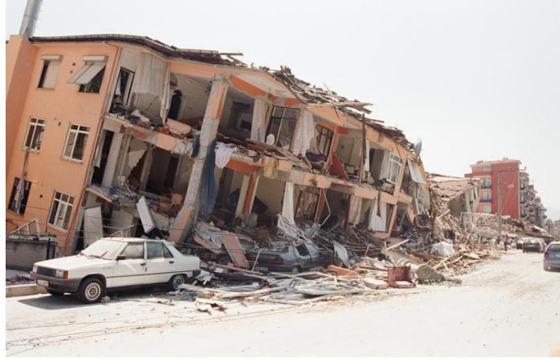
Şekil 2.2.6. 17 Ağustos 1999 Marmara Depremi Kalıntıları
