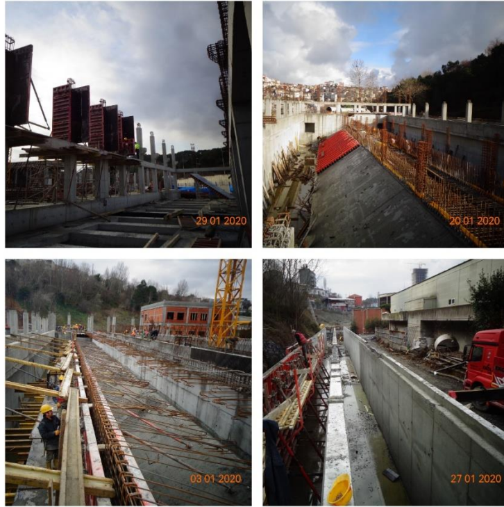
Resim 3.5: Trafo Kolon, Kum ve Yağ Tutucu Eğik Perde ve Yürüme Yolu, Kanal Perde İmalatları
