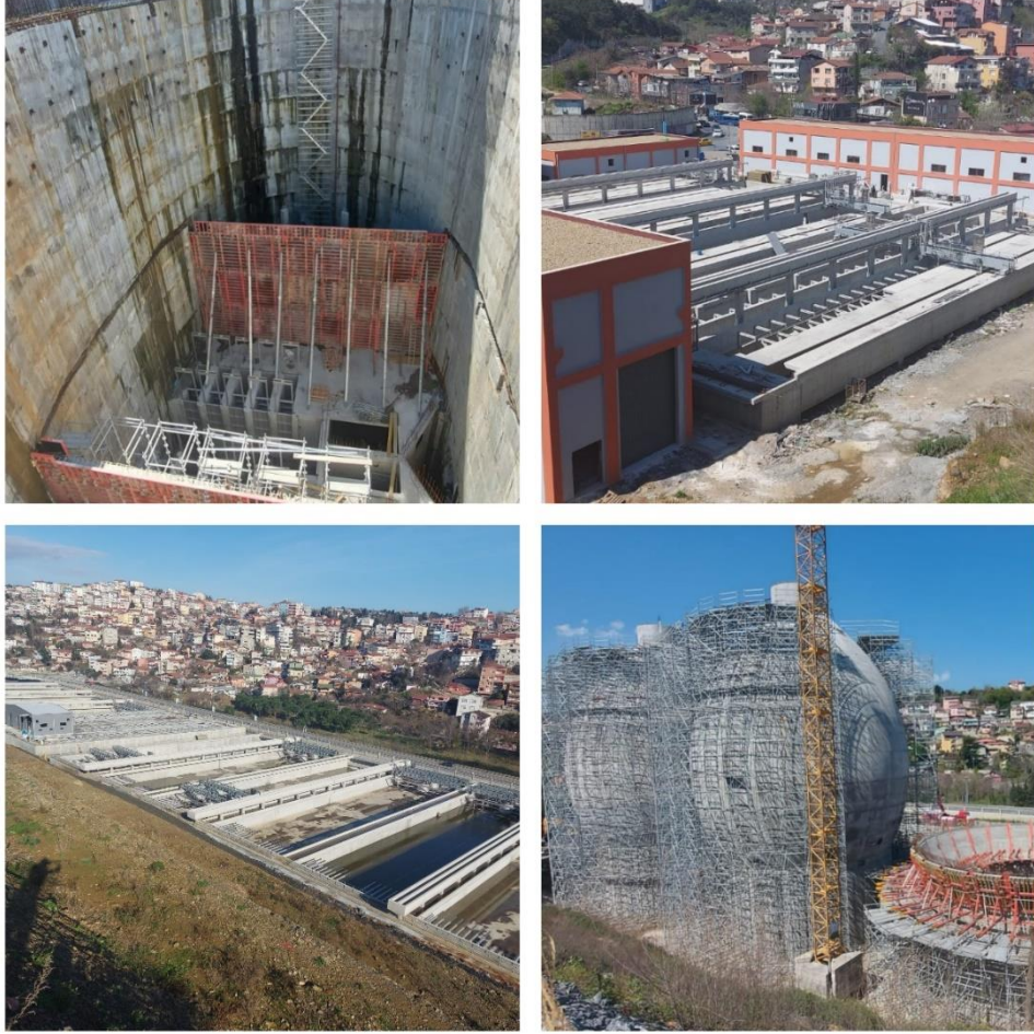
Resim 3.2: Terfi, Kum ve Yağ Tutucu, Havalandırma Havuzları, Çürütücü Tankları
