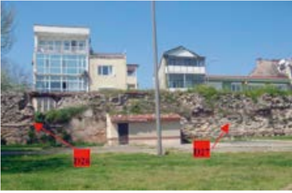
Şekil 8. Marmara Surları 97 ile 99. kuleler arası D26 (dolgu harcı) ve D27 (derz harcı) örneklerinin alındığı yerler
