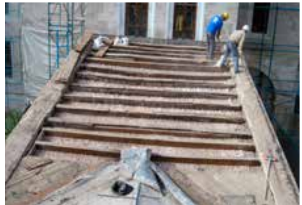
Fotoğraf 3. Hünkâr Kasrı giriş rampası ahşap hatlı hasarları
