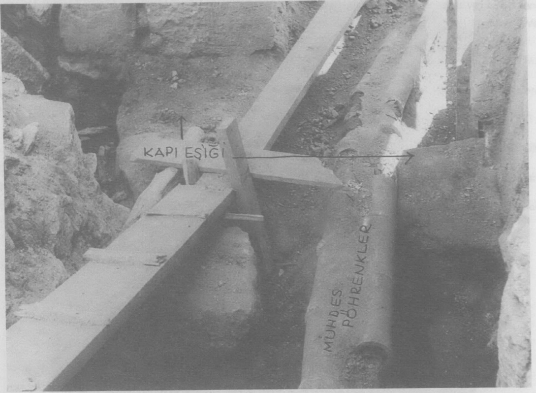
Res. 6: Islak alan kapı eşiği üstündeki muhdes pöhrenkler ve solda üst kat merdiven kapı eşiği.
