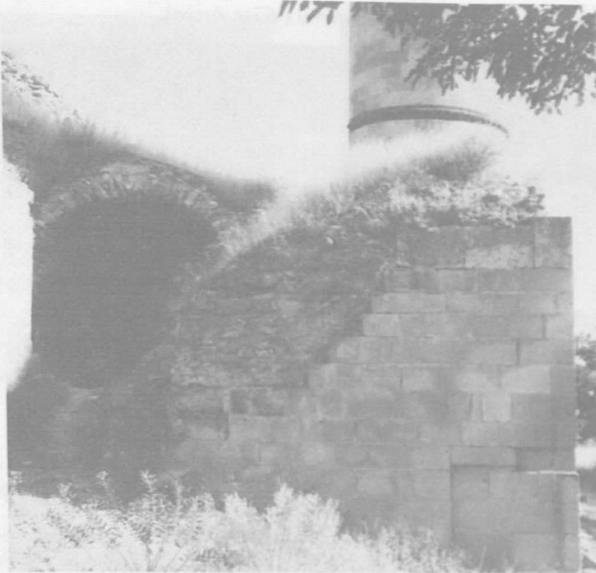
Res.19: Pertek, Çelebi Ali Camii, çeşme kuzey cephe, taşınmadan önceki durumu (VGM Arşivi).
