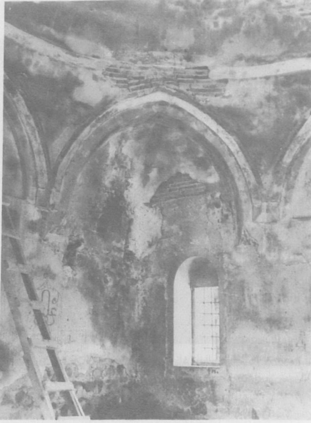
Res.25: Pertek, Çelebi Ali Camii, kubbeye geçiş, taşınmadan önceki durumu (VGM Arşivi).
