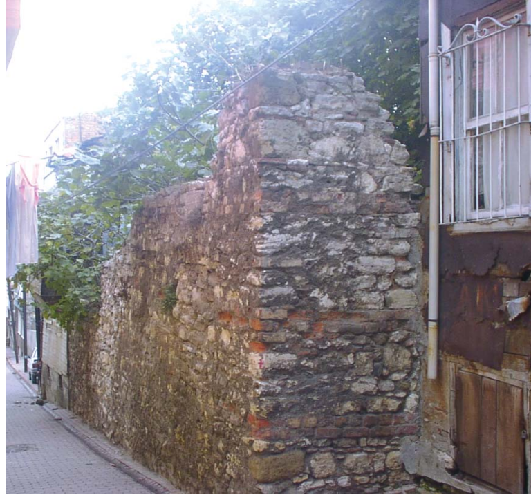
Resim 19: Mescitten geriye kalan duvar
