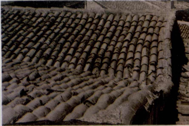
Resim-5 Dam Kiremitleri İlk Durumu
