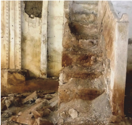
Fot. 25. Değirmenyolu/Parlasan Köyü Hacı Ahmet Camii yıkılmış minber merdivenleri.
