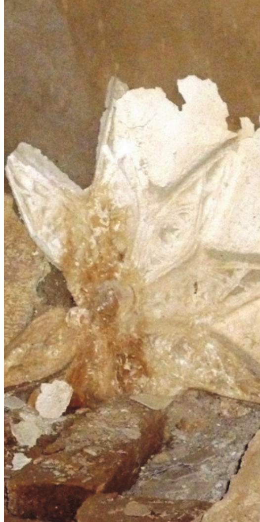
Fot. 28.: Değirmenyolu/Parlasan Köyü Hacı Ahmet Camii yıkılmış minber yan aynalıktan dökülen alçı süslemeler.
