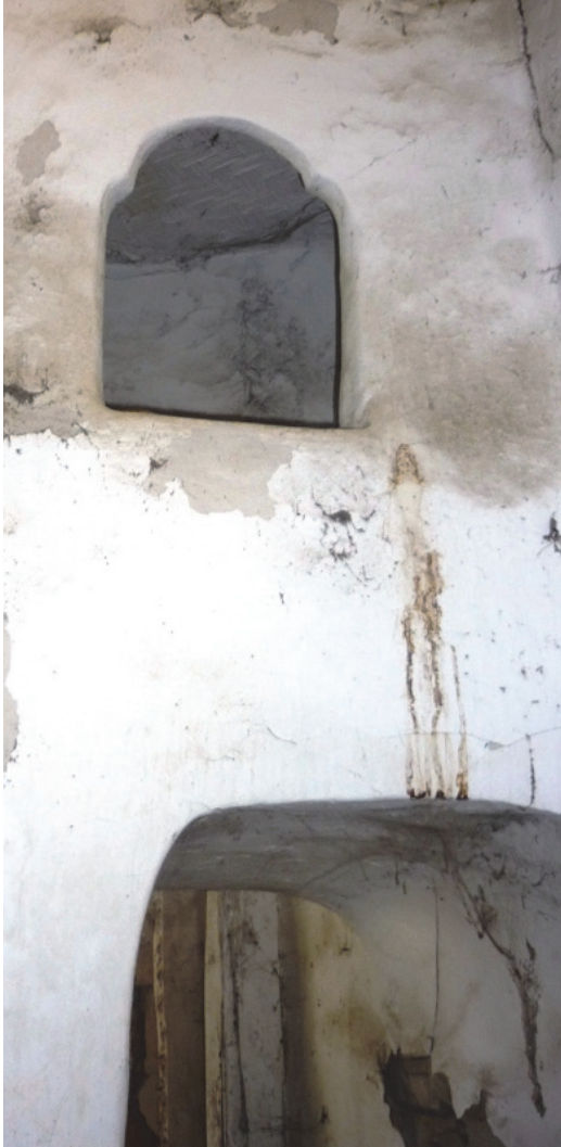
Fot. 27: Değirmenyolu/Parlasan Köyü Hacı Ahmet Camii yıkılmış minberi taht ve taht altı geçidi.
